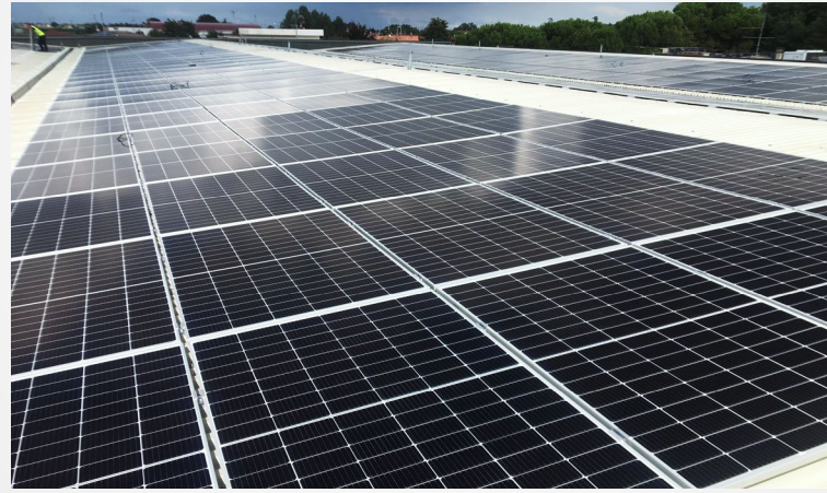
Sant'Agata sul Santerno (RA) 492 kWp
