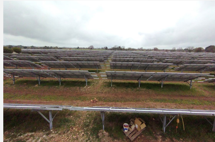
Gioia del Colle (BA) 6700 kWp
