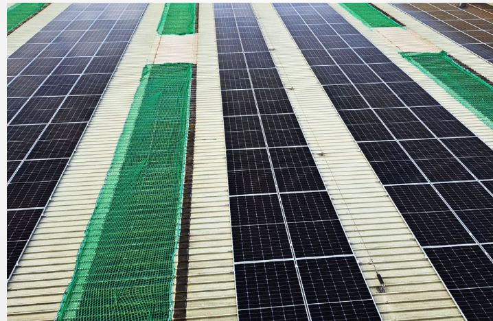
Villa Poma (MN) 4200 kWp
