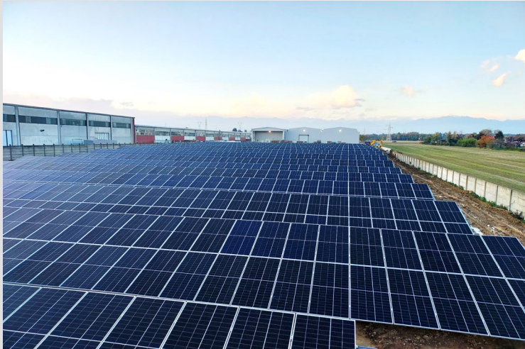
Grosso (TO) 980 kWp
