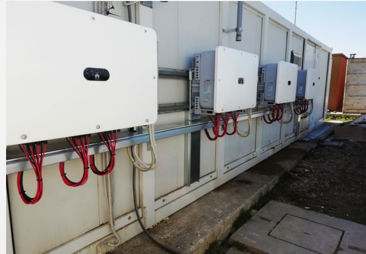
Novoli (FI) 1000 kWp
