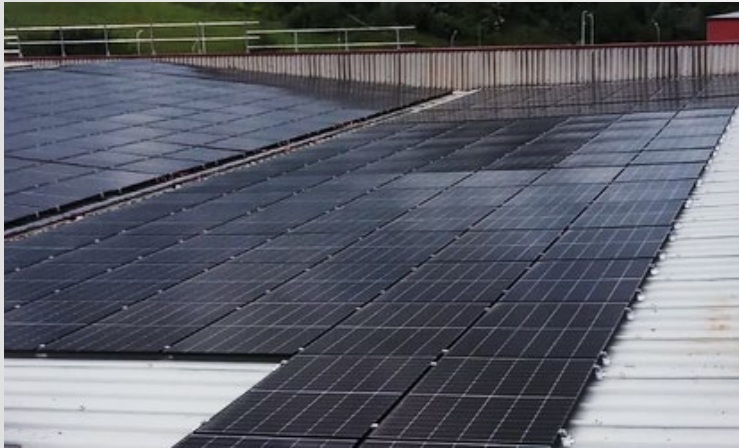
Contursi (AV) 1000 kWp
