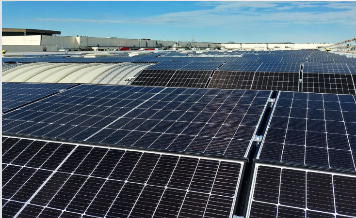
Arese (MI) 830 kWp
