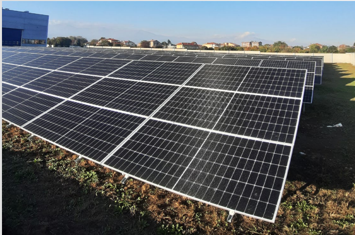
Ciriè (TO) 1600 kWp
