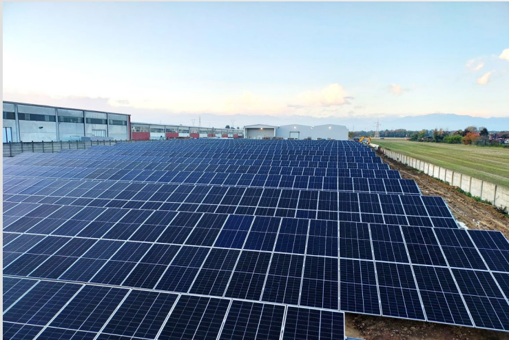
Grosso (TO) 980 kWp
