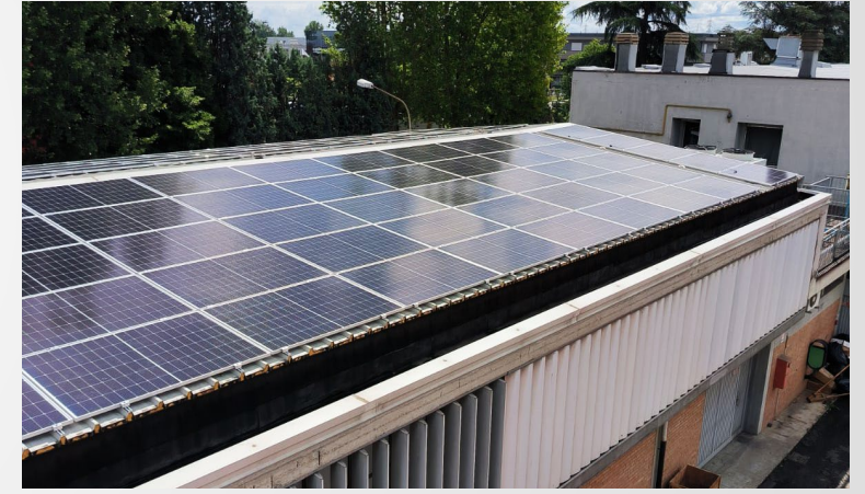
Modena (MO) 360 kWp
