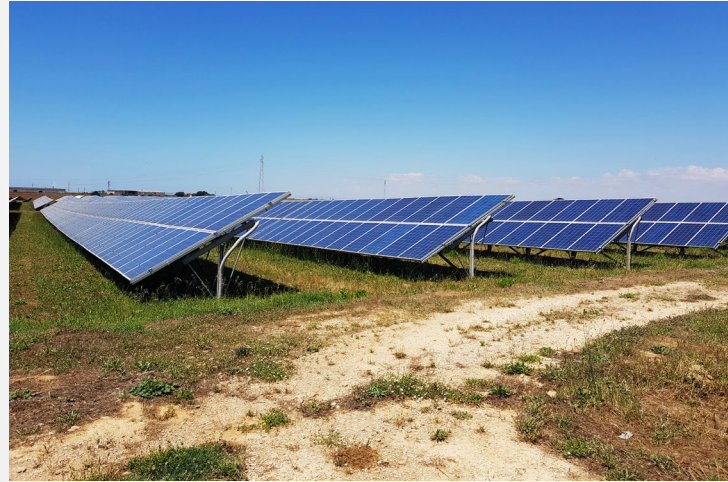
Ginosa (TA) 5000 kWp
