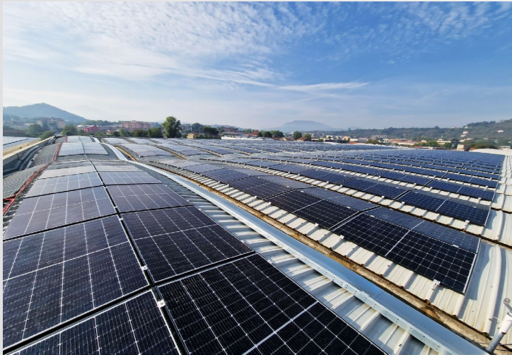
Atripalda (AV) 2500 kWp
