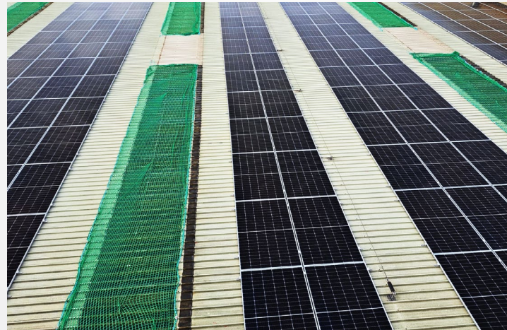
Villa Poma (MN) 4200 kWp
