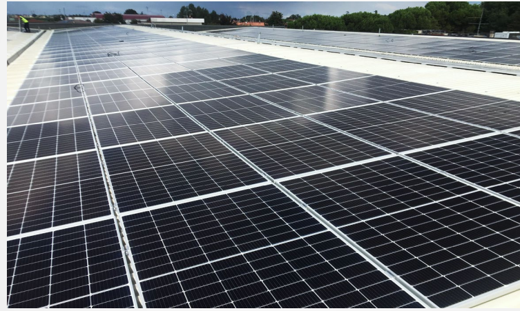
Sant'Agata sul Santerno (RA) 492 kWp
