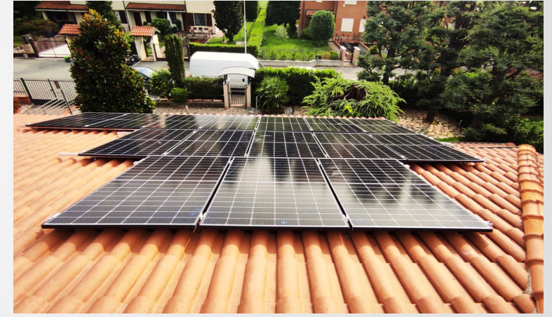
Pozzo d'Adda (MI) 6 kW
