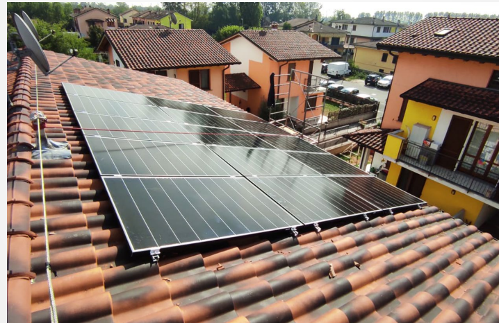
Casalpusterlengo (LO) 6 kW
